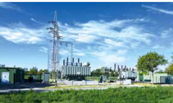
Foto: WT Energiesysteme GmbH
